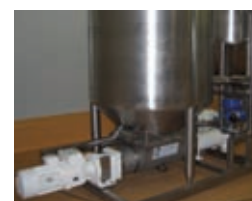
Pompe IVA PCM montée sous une cuve de stockage
