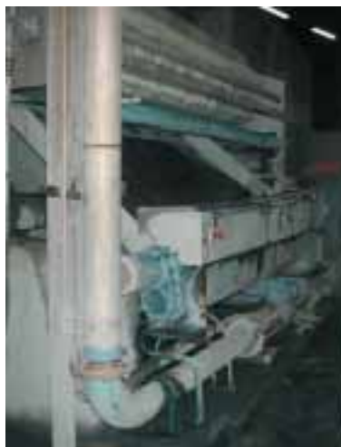
Gavopompe (GBB) sous filtre presse
