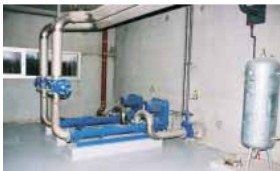
Injection de polymère (15 bar) proportionnel au débit de boue
