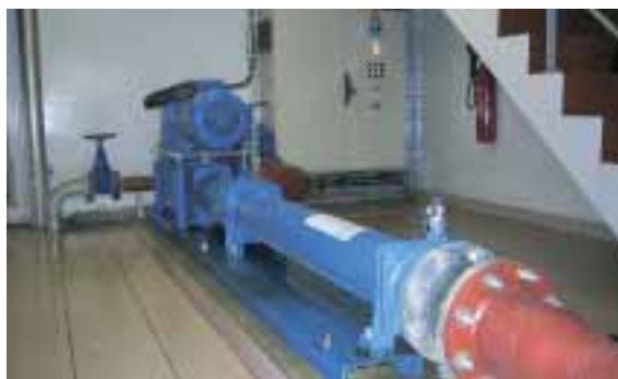
Ensemble pompe + armoire
