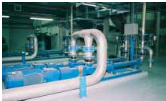
Alimentation de filtre presse avec 2 pompes Moineau
