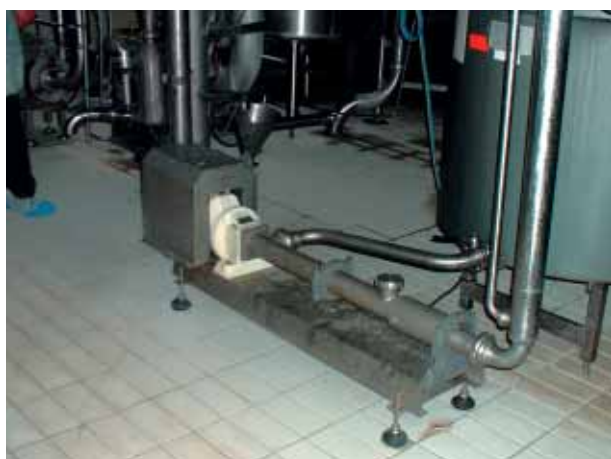
13H6 dans l'industrie laitière pour le transfert de lait concentré vers un évaporateur.
