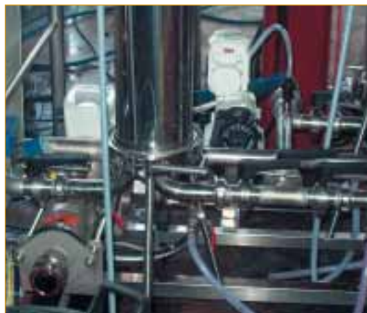
Pompe sur palette de filtration (vinicole)
