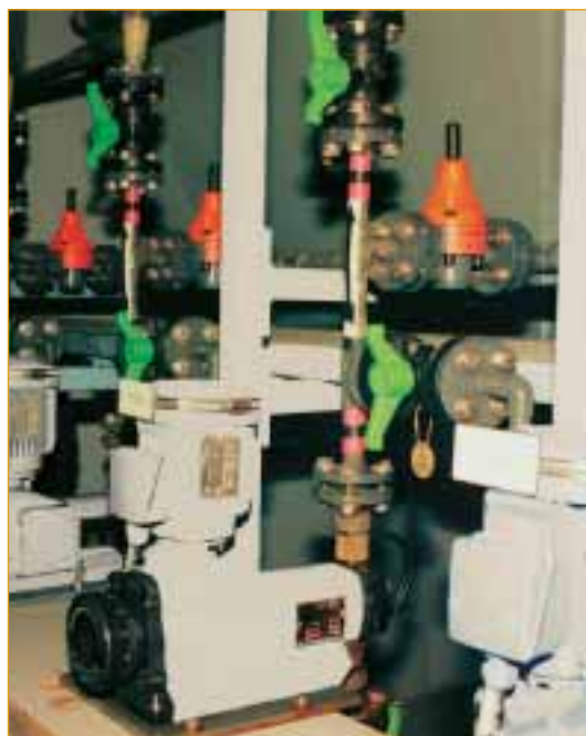
Pompage de chlorure ferrique en station d'épuration
