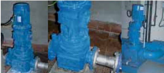
Recirculation de boues : Porto-Freixo et Versailles-Sevesc
