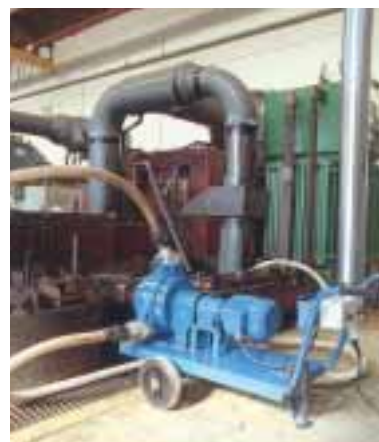
Pompe Z en vidange de puisards
