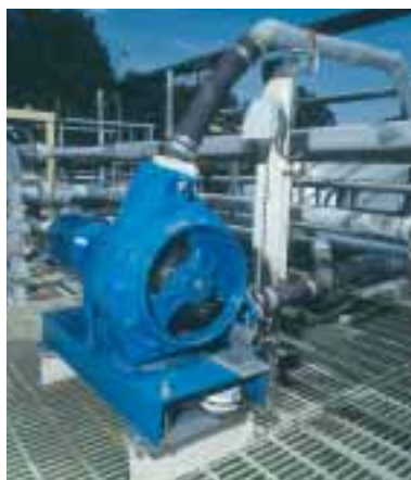
Pompe Z en neutralisation d'effluents
