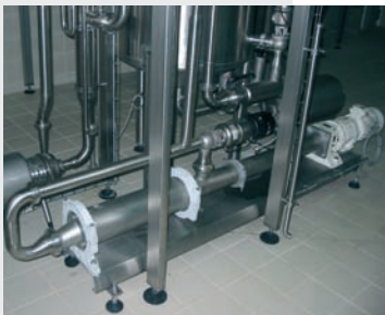
Pompe hygiénique à vis excentrée PCM Moineau™ pour le transfert du yaourt.
